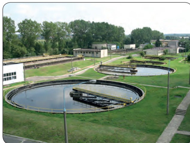
Oczyszczalnia ścieków w Białej Podlaskiej Fot. Archiwum WIOŚ
