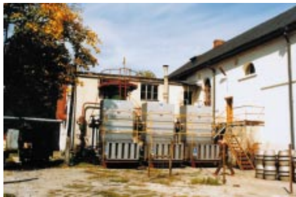
Wieże chłodnicze z zabezpieczeniami akustycznymi w Browarze Zwierzyniec Fot. Leon Sapko
