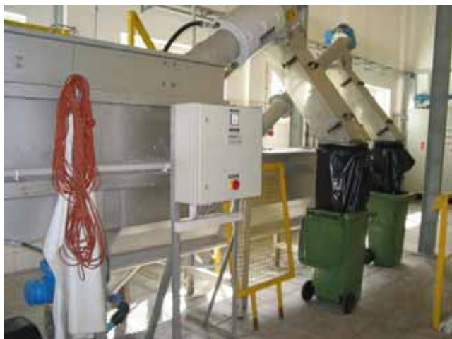
Zblokowane urządzenie do wstępnego oczyszczania ścieków na gminnej oczyszczalni w Suścu fot. WIOŚ Delegatura w Zamościu
